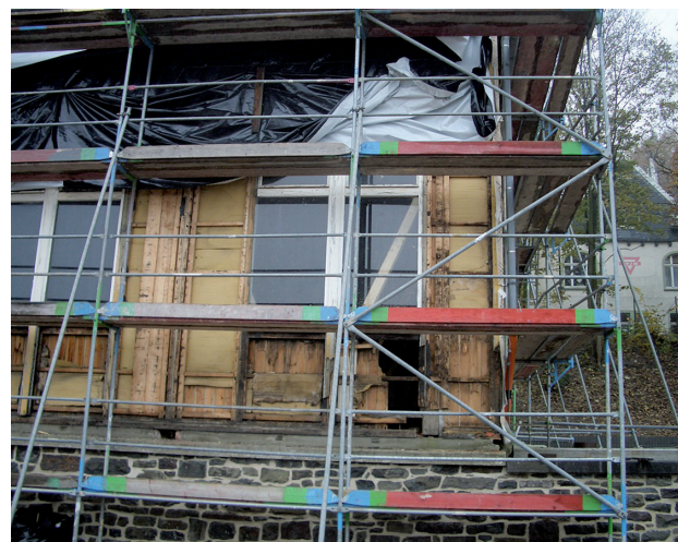
Öffnung der Hallenwand, hier teilweise (unten rechts) etwas stärker durch hinaufgekrochene Pilze geschädigt.
