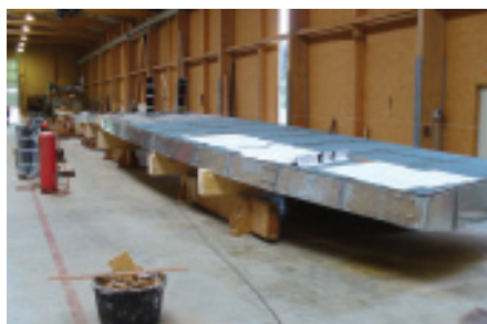
Bild 4 Der in Blockverleimung gefertigte Holzkorpus erhielt bereits im Werk Anschlussbleche für die ...
