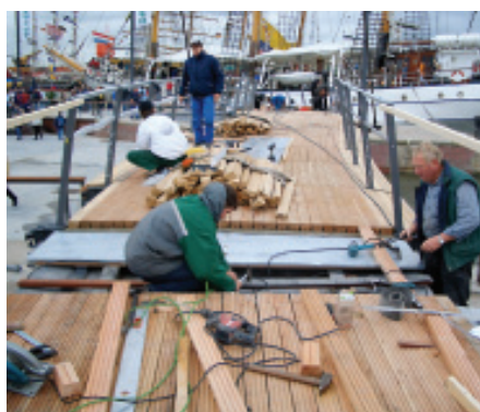
Bild 11 Handwerklicher „Anschluss“ der Rampen an den Brückenkörper
