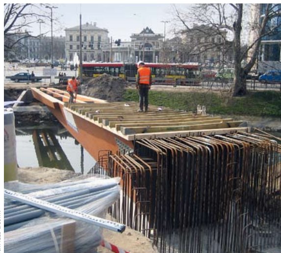
▼ Die BS-Holz-Platte und die keilförmigen Querbalken wurden vor Ort verlegt. Im Vordergrund: die Bewehrung für die Einspannung im Widerlager
