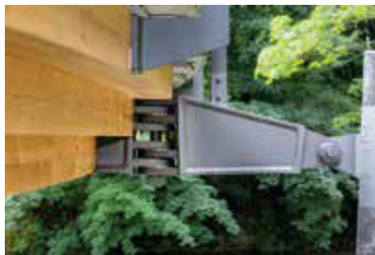
6 Anschluss des Brückenträgers an den Stahlmast: Möglichkeit der zwängungsfreien Verdrehung © Ingenieurbüro Miebach
